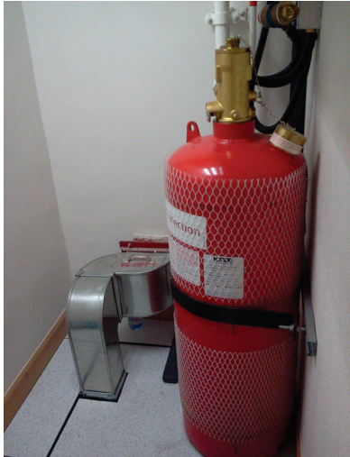
FM200以七氟丙烷為滅火劑，不會損壞伺服器。
